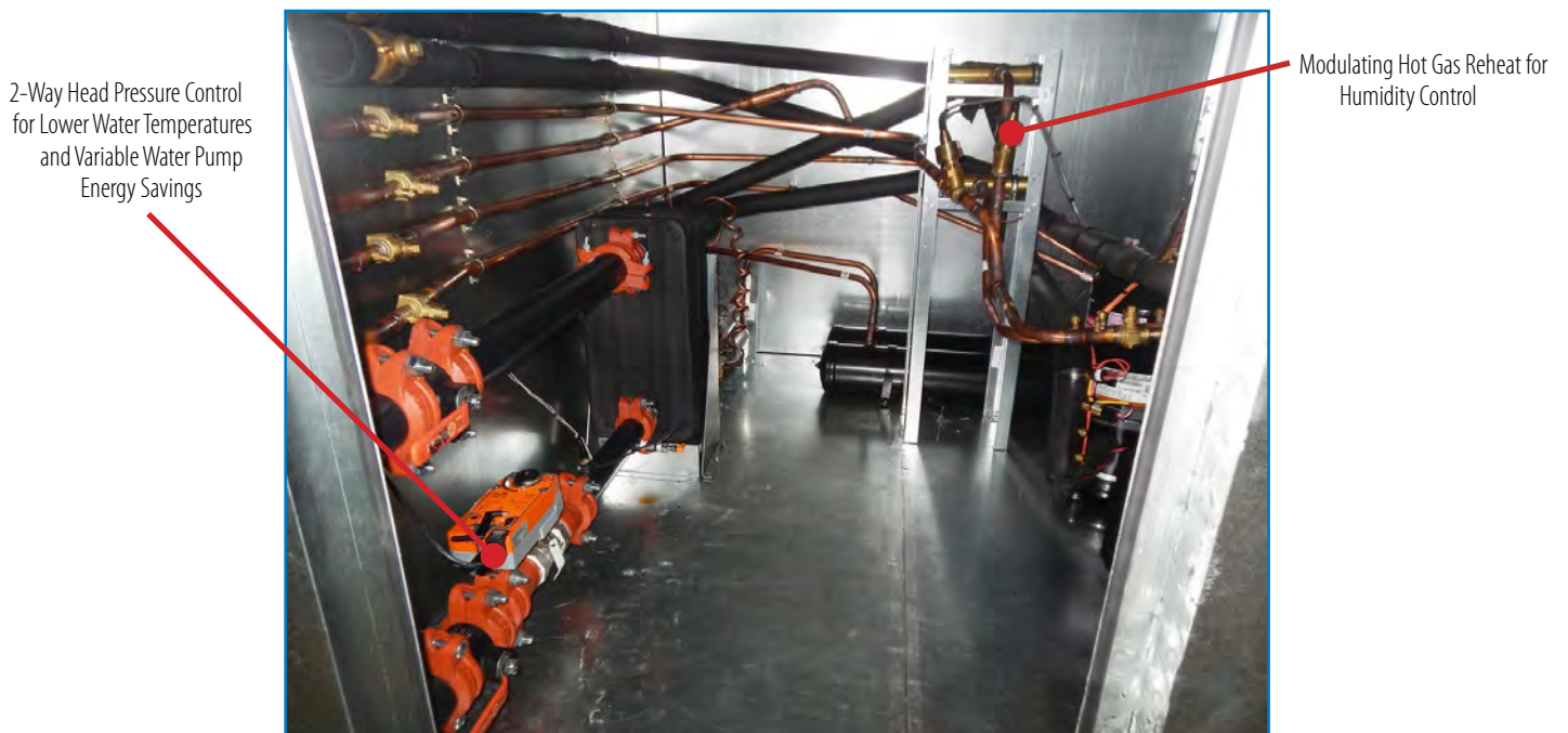
30 ton WSHP Module Interior
