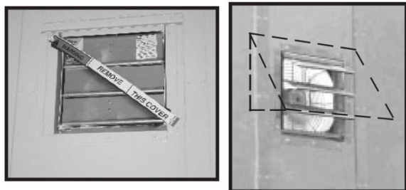
Figure 14 - Vestibule Exhaust Fan
